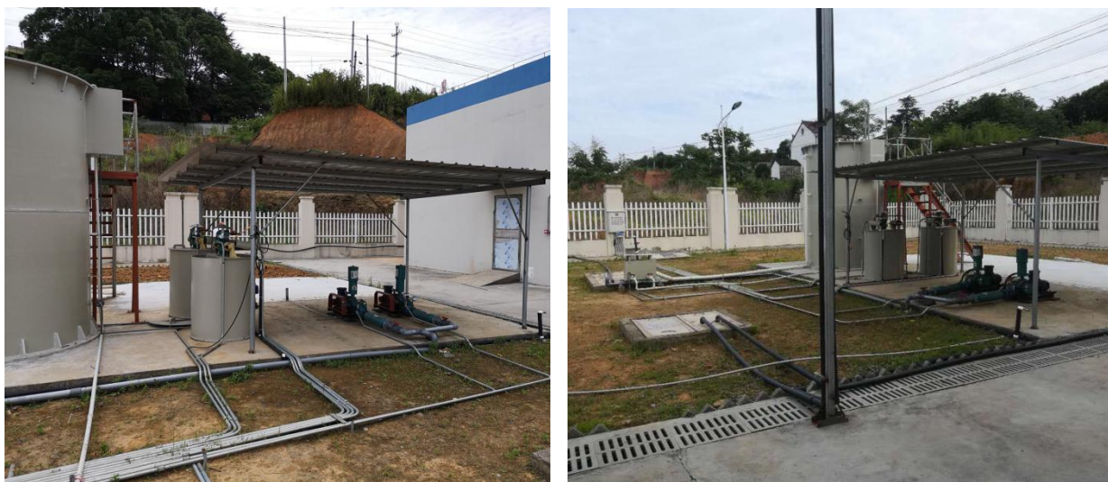
图 4-3 企业污水站现场照片
