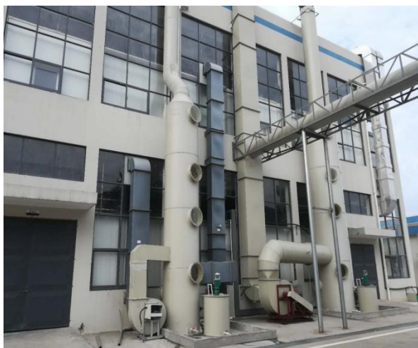
1#、2#废气处理设施
