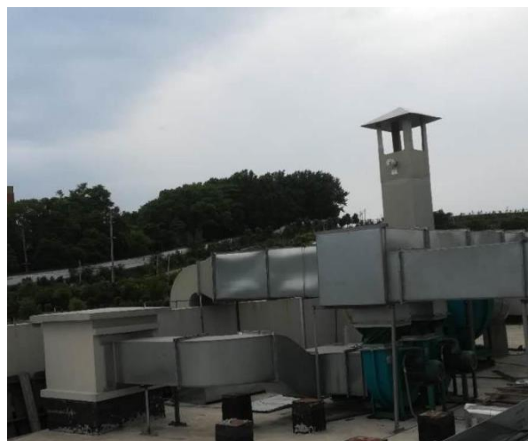
3#废气处理设施
