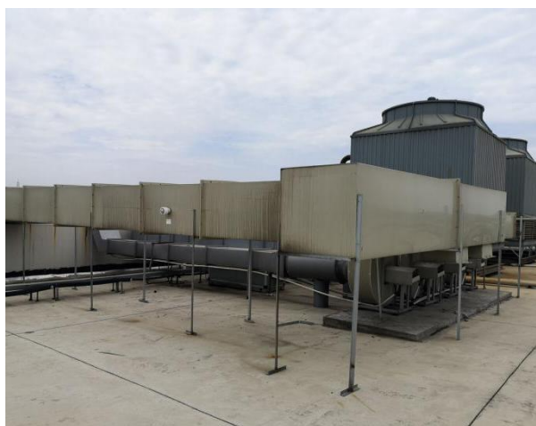
1#、2#废气处理设施
