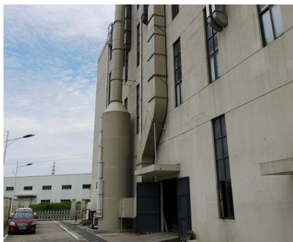
3#废气处理设施
